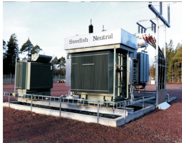
Рис. 2. Установка компенсации емкостных токов производства компании Swedish Neutral, Швеция [6]
