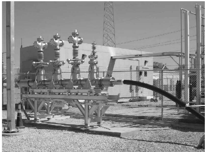
Рисунок 2.31 – Початкова частина триаксіального ВТНП кабелю довжиною 200 м, установленного на підстанції Біксбі, штат Огайо (США)
