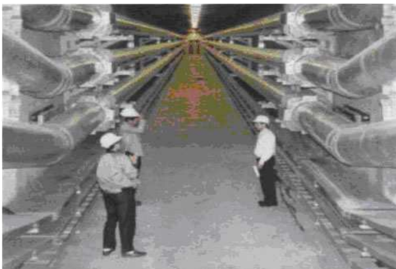
Рис. 4. Элегазовый токопровод на напряжение 550 кВ (Westboro, США)
