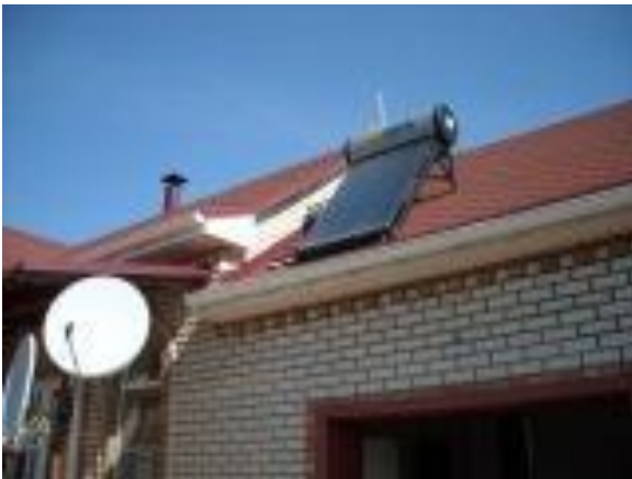
Рисунок 14. Вакуумный СК на крыше дома
