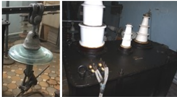
Рисунок 1 – Ізолятор (зліва), підвищувачи трансформатор (справа)
