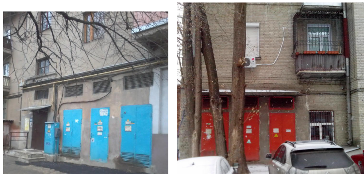
Рисунок 1.21 – Вбудовані у житлові будинки міські ТП
