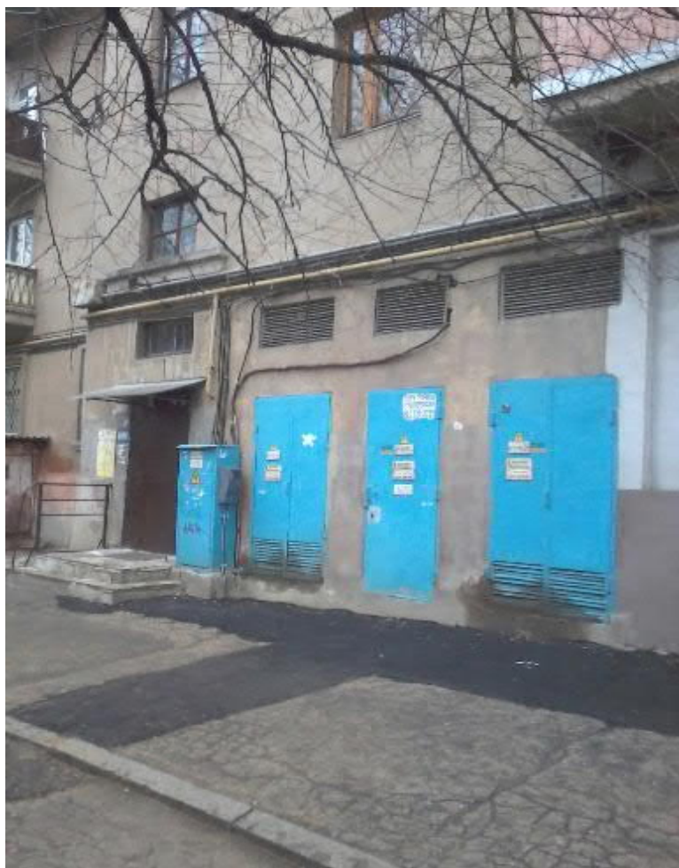
Рисунок 4.1 – Типова вбудована трансформаторна підстанція
