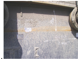
Рис. 7. Замеры толщины по балкам ходовым, зачищено место на участке механического сужения в связи с воздействием ролика и на свободном участке (ОШС черт. 126.00.00.000)
