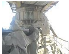
Рис. 6. Налипание грунта на металлоконструкции в связи с постоянным смачиванием (ОШС черт. 126.00.00.000)
