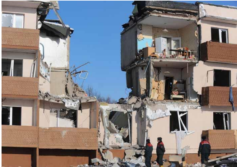
Рис. 1.5 – Сильне руйнування будівлі
