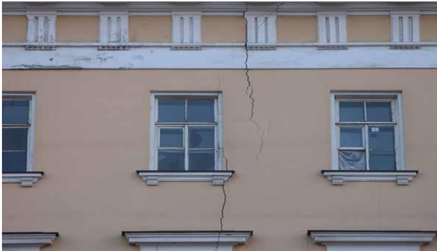
Рис. 1.7 – Слабке руйнування будівлі
