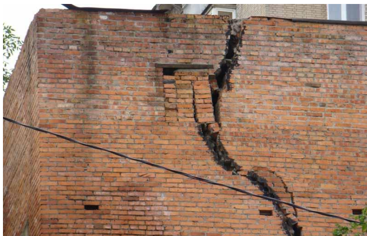
Рис. 1.6– Середнє руйнування будівлі
