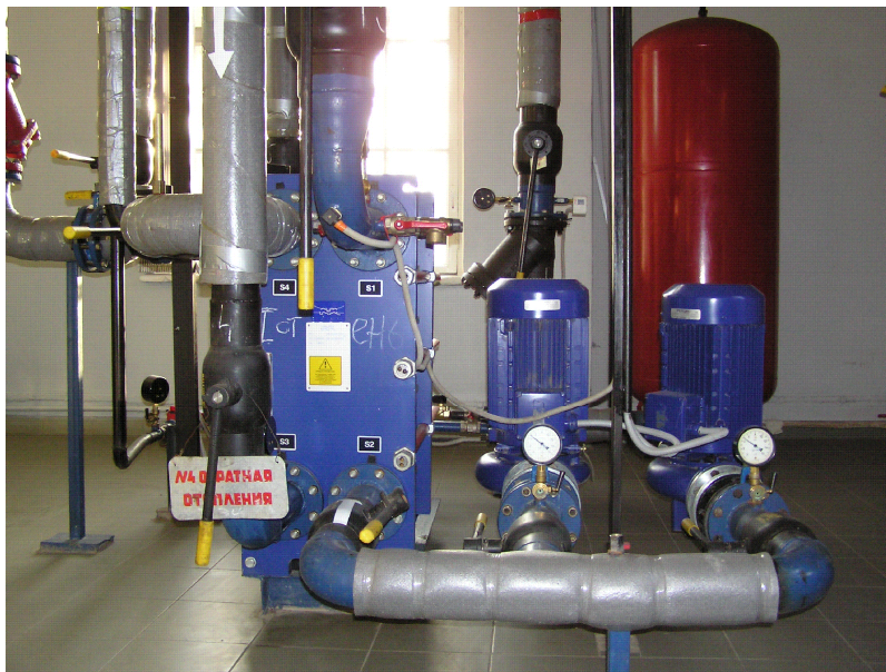
Рисунок 2 – Общий вид теплового пункта «АО «Содружество-Т» системы отопления здания и ГВС на базе пластинчатых теплообменников
