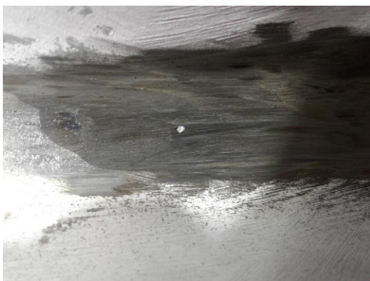
Рис. 8 – Дефект сварного шва на камере СОД, который виден визуально
