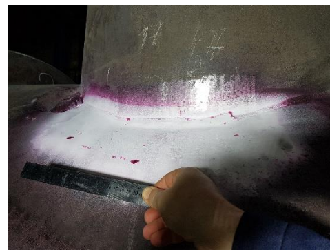
Рис. 10 – Дефект сварного шва на камере СОД после «переварки» при контроле проникающими веществами
