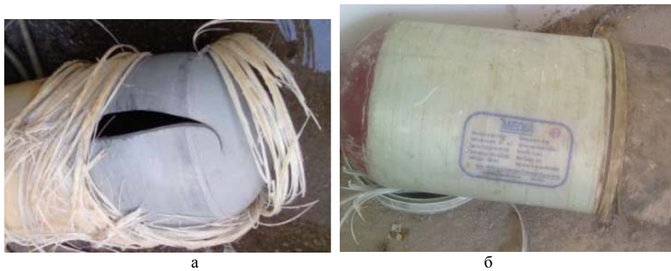
Рис. 2 – Стан поверхні сталеві оболонки балона: а - зруйновано в процесі випробувань; б - зруйновано після експлуатації на транспортному засобі впродовж тривалого періоду
