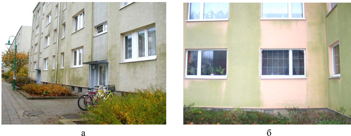
Рис. 1 – Примеры биоповреждений фасадов жилых зданий: а – г. Буххольц (4 года эксплуатации); б – г. Киль (7 лет эксплуатации).
