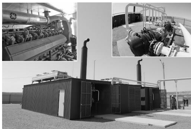
Рисунок 1 – Газові установки з утилізації звалищного газу (біогазу).
