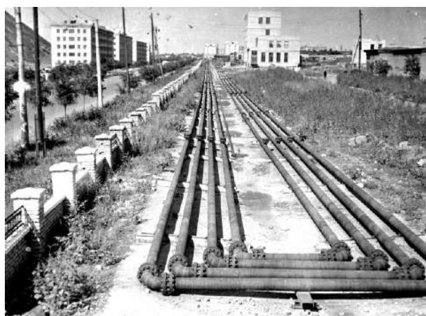
Рис. 5.9. Експериментальний стенд Донецького науково-дослідного центру з 4-х км трубопроводом
