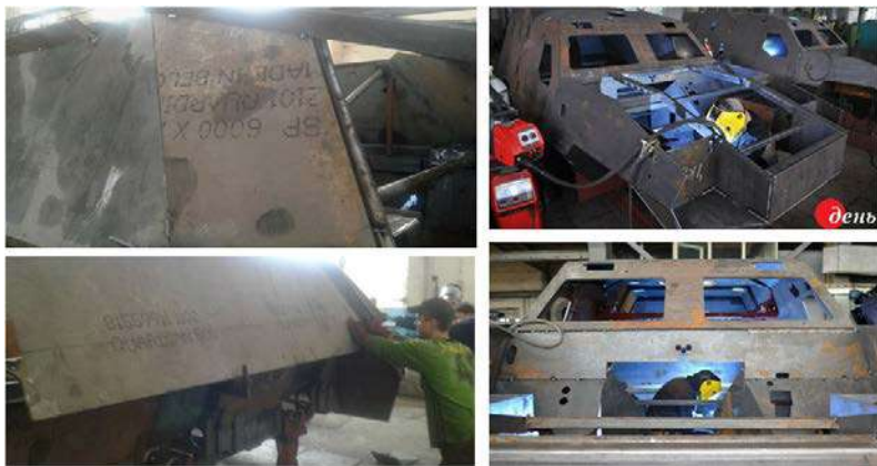
Рисунок 12. Приклади низького рівня організації складально-зварювальних робіт корпусів ББМ через брак спеціалізованого устаткування для складання та переміщення зварюваних конструкцій
