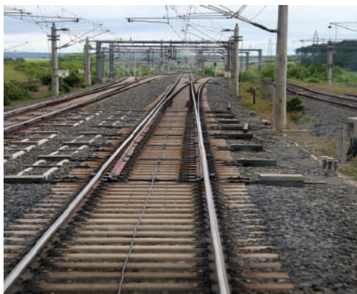
Рисунок 1.16 – Груповий електропривод на стрілочному переводі
