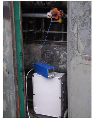
Рис. 4. Загальний вигляд БППС фірми AVL у складі комплексу
