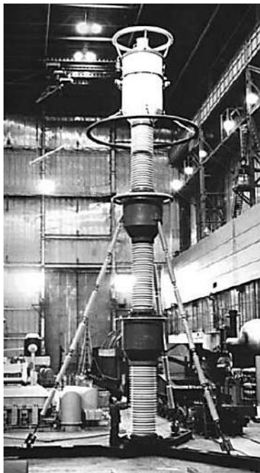
Рис. 18. Каскадний трансформатор струму для першої у світі ЛЕП 1150 кВ
