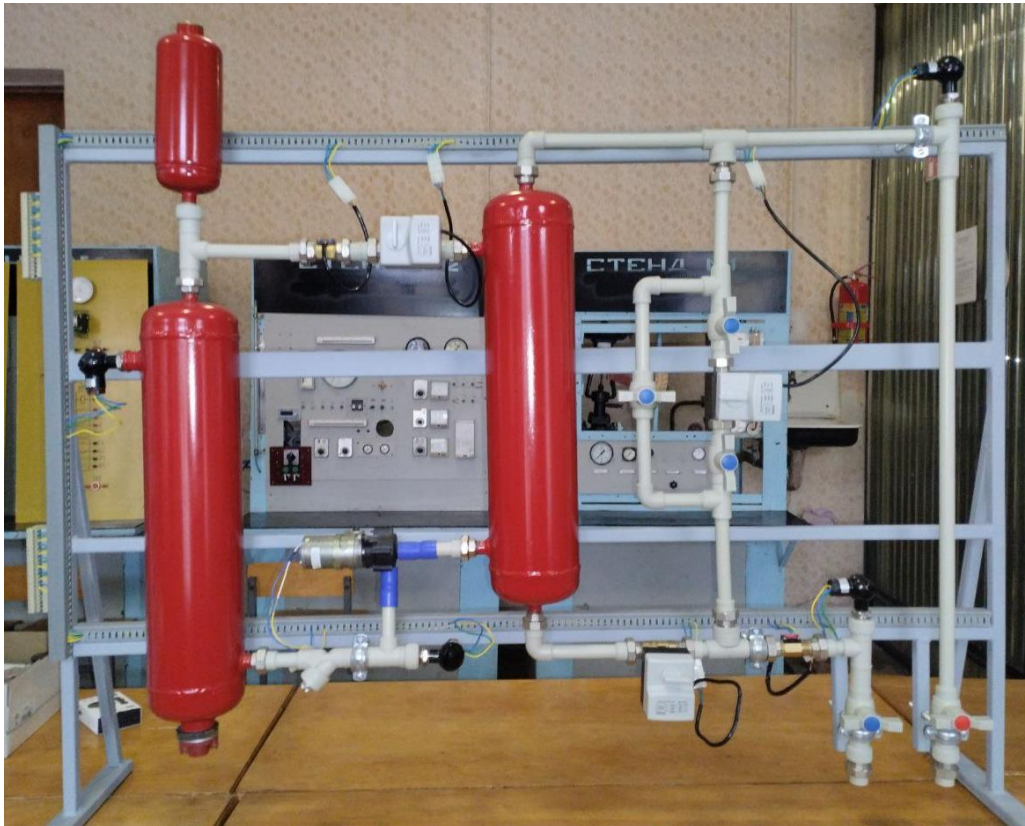
Рис. 1 – Технологічна частина лабораторного комплексу «Теплопункт»
